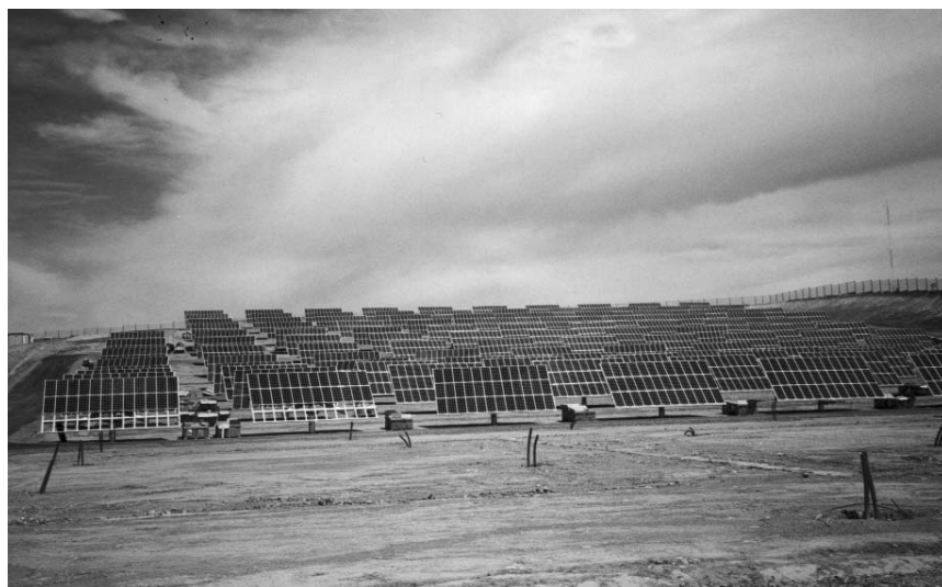
Planta solar fotovoltaica
