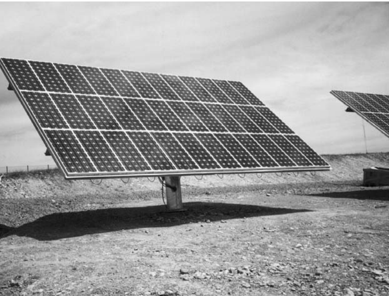
Panel de placas solares de energía fotovoltaica.
